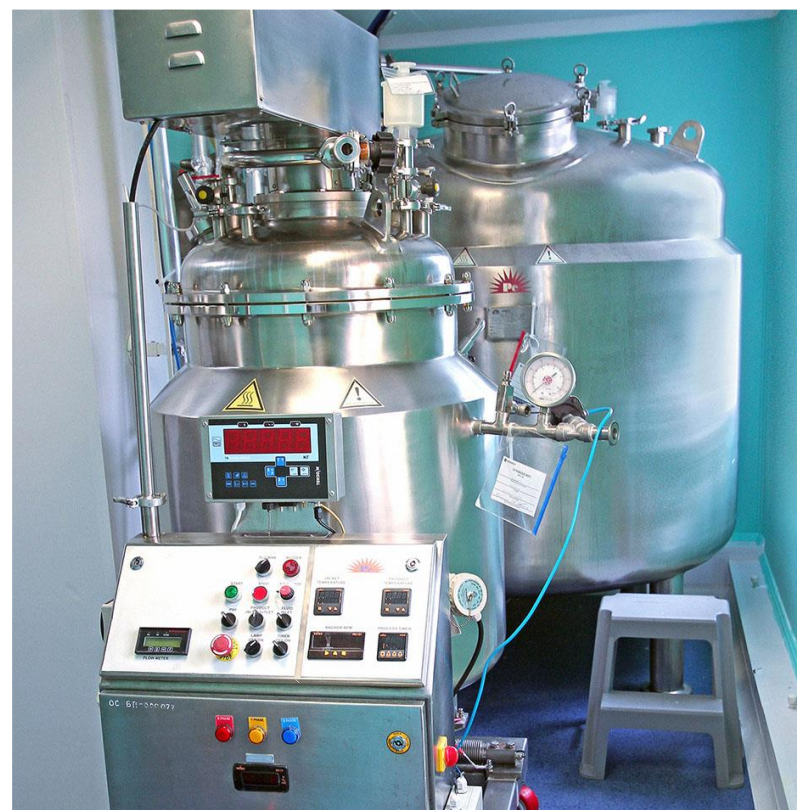
Реакторы приготовления инъекционных растворов
